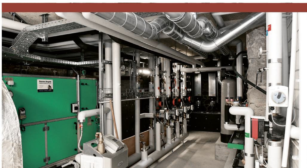
Die Lüftungsanlage für den Konzertsaal.
