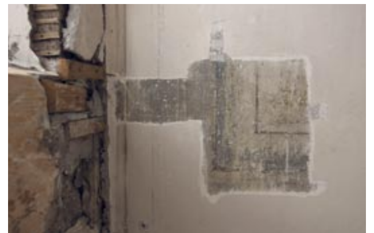
Schicht um Schicht: Bis zu zehn Farbschichten befinden sich an den Wänden und verbergen teils kunstvolle Verzierungen.
